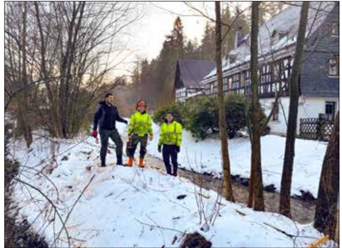
Verbandseigene Mitarbeiter bei der Beseitigung von Erlenaufwuchs, welcher im Hochwasserfall zum Abflusshindernis und damit zu einer Gefahr für angrenzende Gebäude werden könnte
